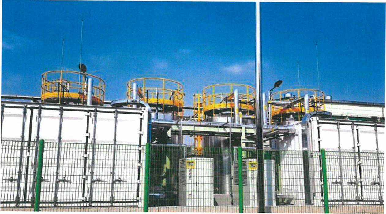
드림엔지니어링이 감리사업을 수행한 OCI-바나등 전지 ESS 현장.
